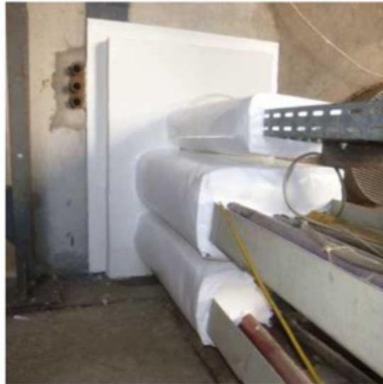
Exemple de protection passive : passage de câble ignifugé
